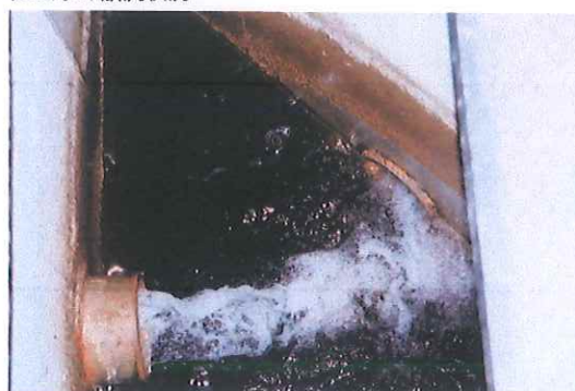
処理水の放流状況
